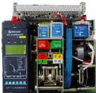
断路器本体 body of breaker
