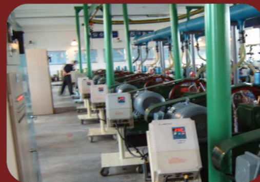
上海宝钢空压机改造车间
