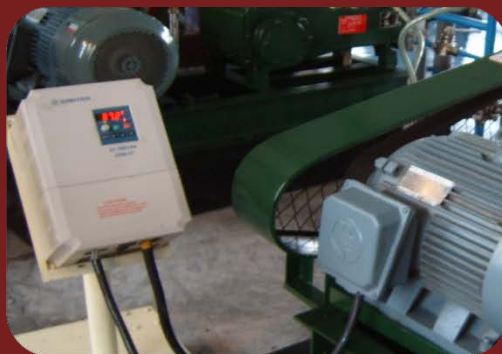
大庆采油二厂注聚泵上的应用
