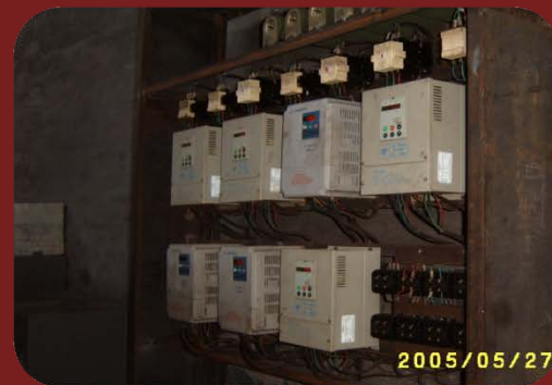
上海宝钢空压机改造车间
