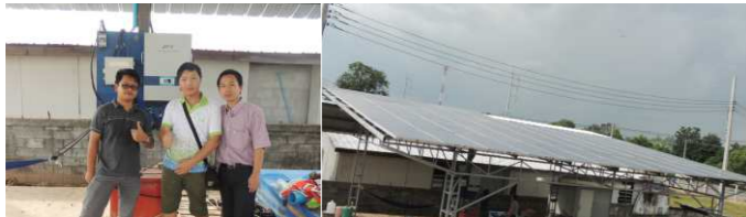
泰国15kW瓦砖厂并网项目
