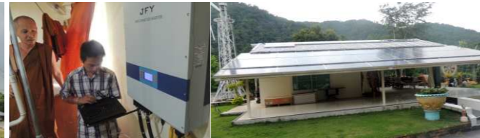
泰国20kW寺庙并网项目
