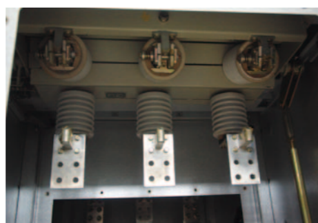
图8 隔离开关分闸位置
