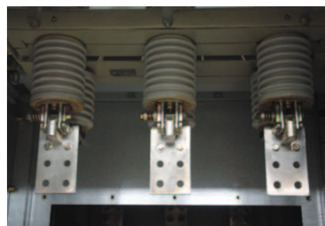
图7 隔离开关合闸位置
