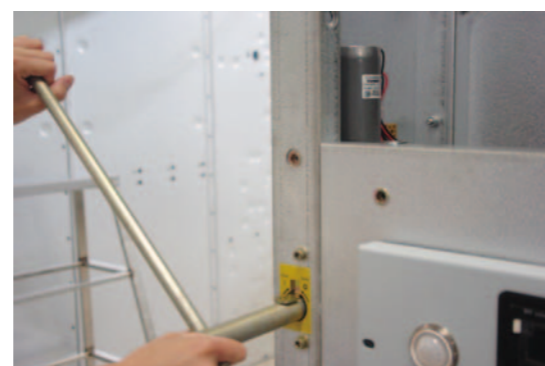
图6 隔离开关由分位到合位顺时针旋转操作
